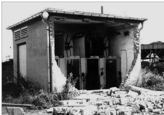
Komplette Zerstörung einer Umspannung nach einem Störlichtbogen (Gebäude schätzungsweise aus den 1960er Jahren).
