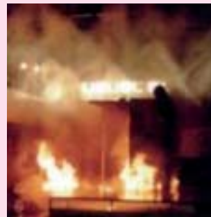
Bild 2: Hochdruckwassernebelanlage im Betrieb (Quelle: Marioff GmbH)
